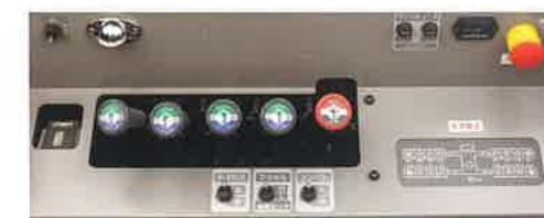
車両後端操作部
