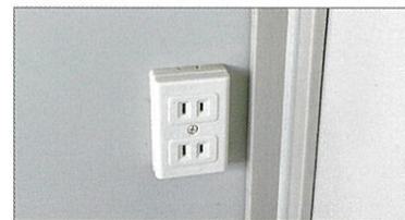
壁コンセント
