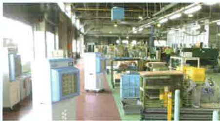
(機械組立工場/RKF405/10台使用)
