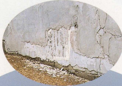
外壁塗膜はがし
