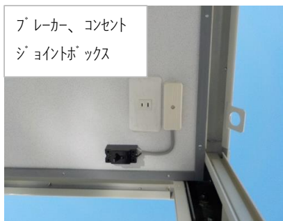
天井対角側コンセント
